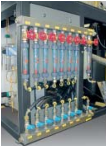
冷却水供应装置
